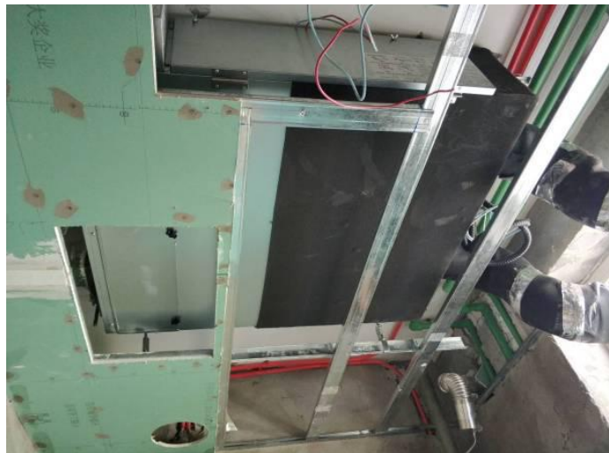
▲放在厨房吊顶里的新风主机
